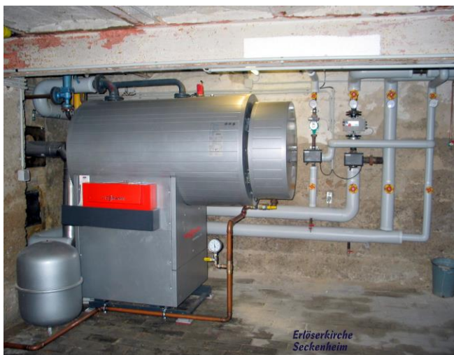
Erdgas-Heizkessel für Kirche und Konfirmandensaal
