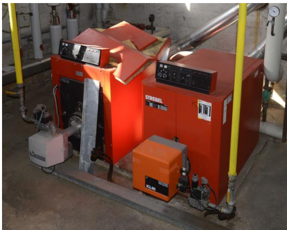
Erdgas-Heizkessel für Gemeindehaus und Kindergarten „Hand-in-Hand“
